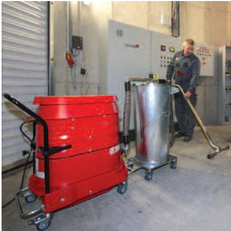
WS 2210 Kojenerasyon tesisinde ön separatörlü
